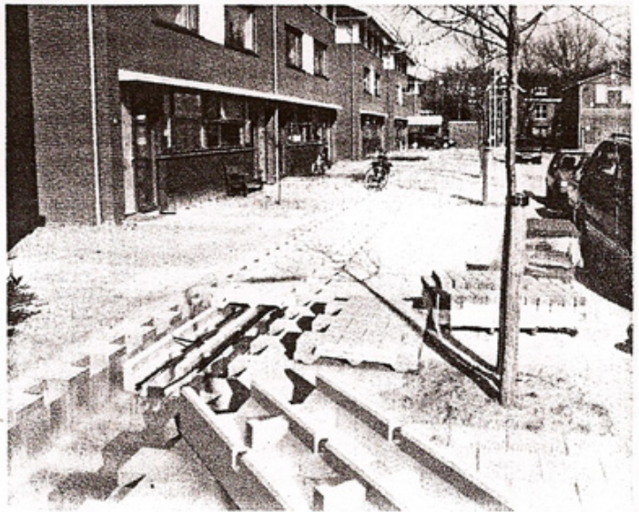
Met name beschadigingen aan kabels door graafwerkzaamheden kunnen bij toepassing van de trottoir kabelgoot in de toekomst drastisch worden teruggedrongen.
